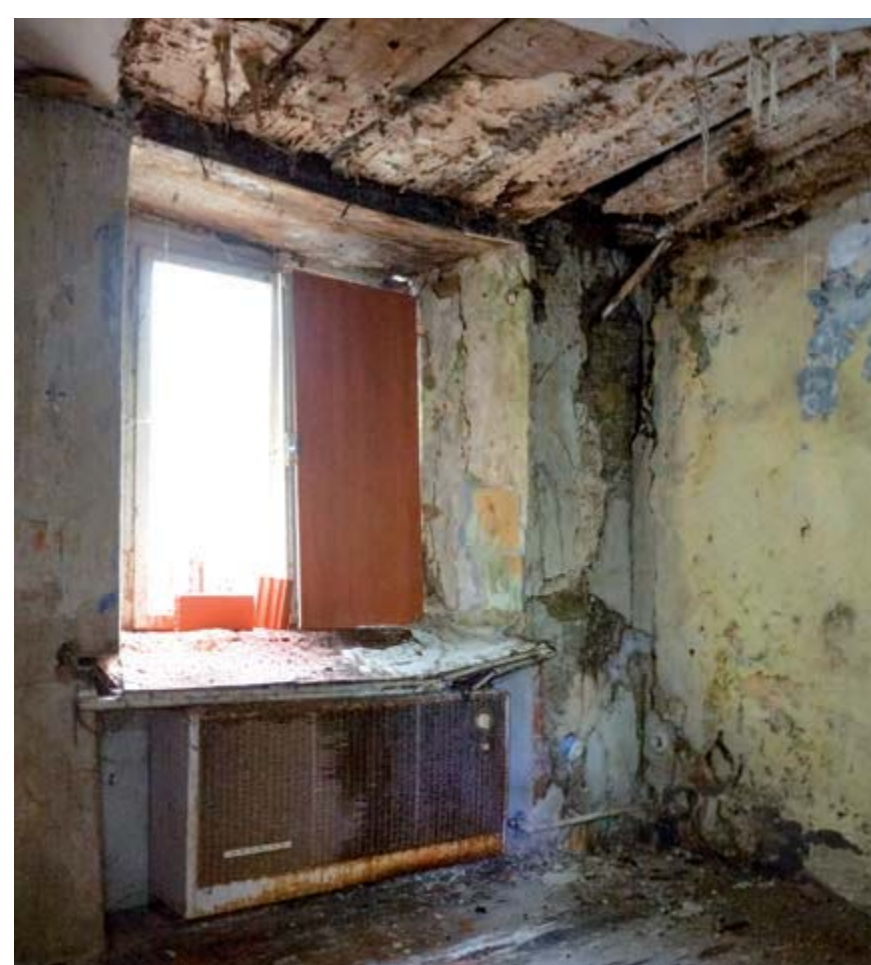
Zustand vor der Sanierung – innen (Foto: Franz Außerstorfer)
